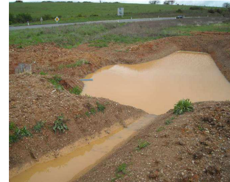
Photographie 5 : exemple de bassin de rétention provisoire
